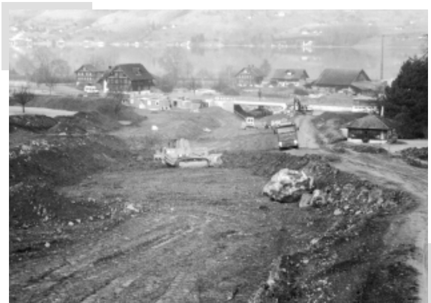
Ein neuer Bach entsteht – mit der Verlegung des Sachsler Dorfbachs wird der Hochwasserschutz für das Dorf Sachseln wesentlich verbessert.
