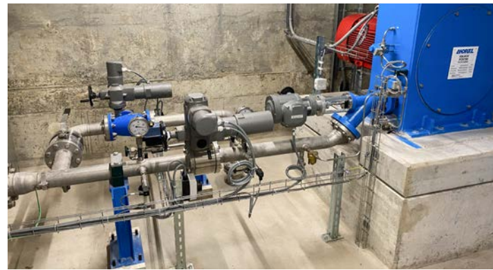
Turbinenanlage im Trinkwasserkraftwerk Pörter in Giswil: Energiegewinnung als «Abfallprodukt» der Wasserversorgung. (Bild: Wasserversorgung Giswil)
