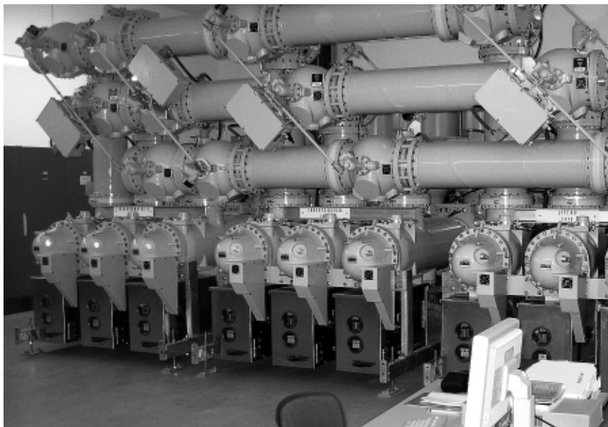
Gasolierte Schaltanlage, Schaltpunkt Giswil
